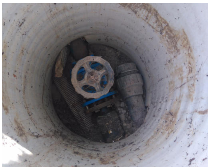
Arqueta de conexión en Alerre
